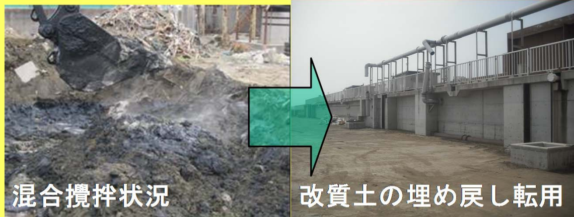
下水処理施設での泥土処理と処理土の活用
