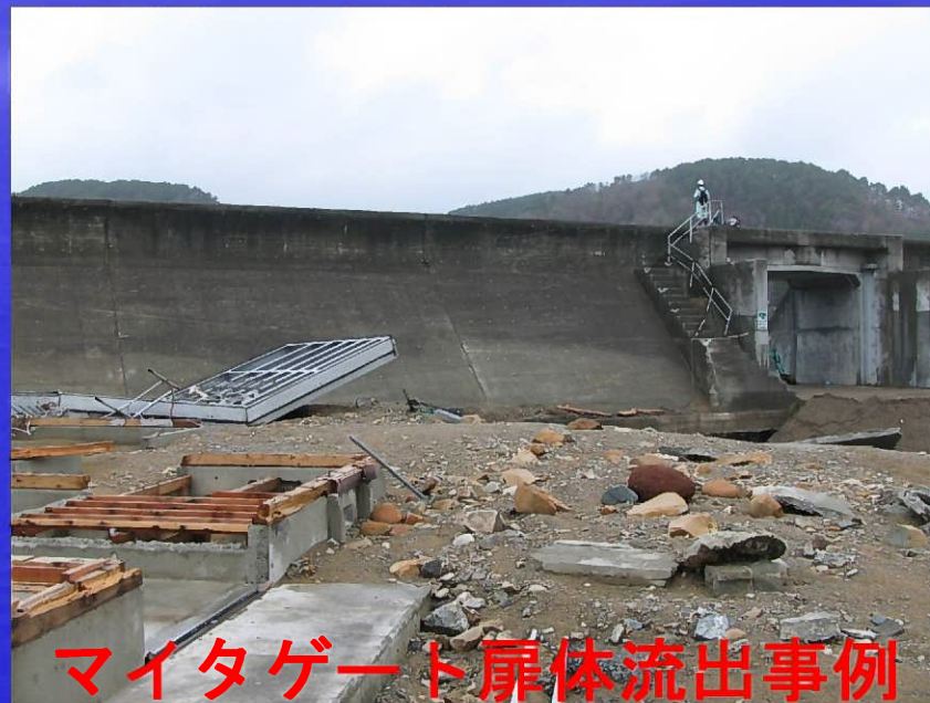
横引きゲート閉鎖失敗事例
