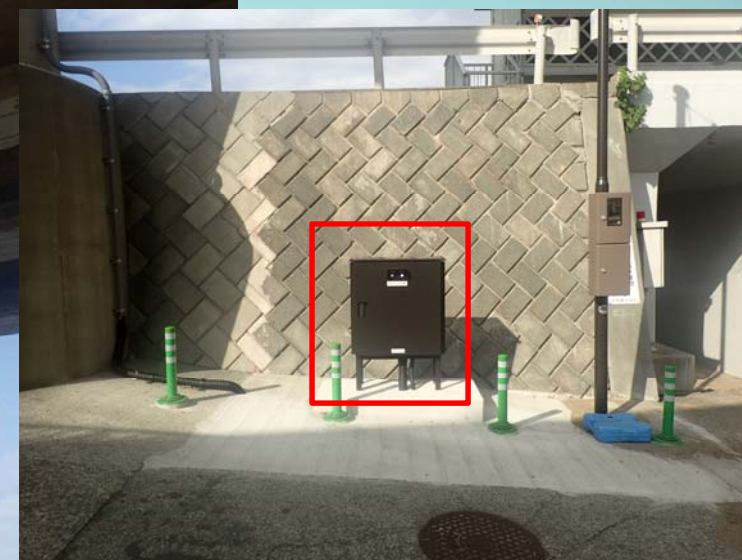
直流電源装置
