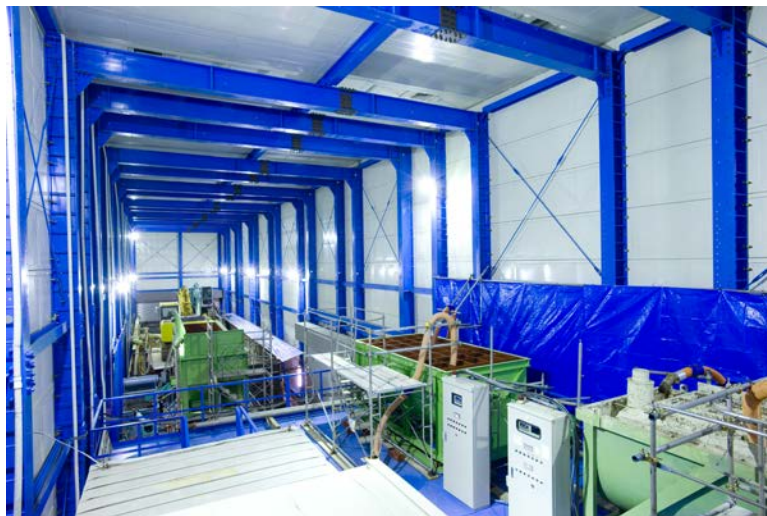
プラント内部
