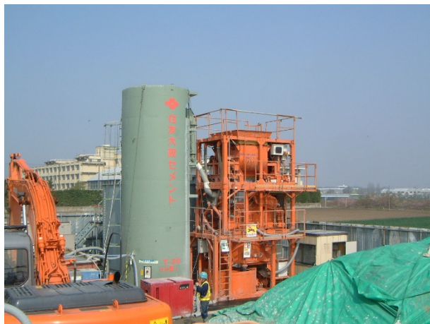
プラント全景 (現場プラント)
