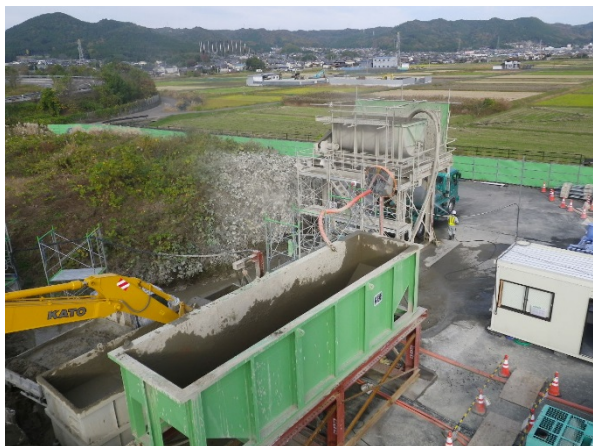
プラント全景 (現場プラント)
