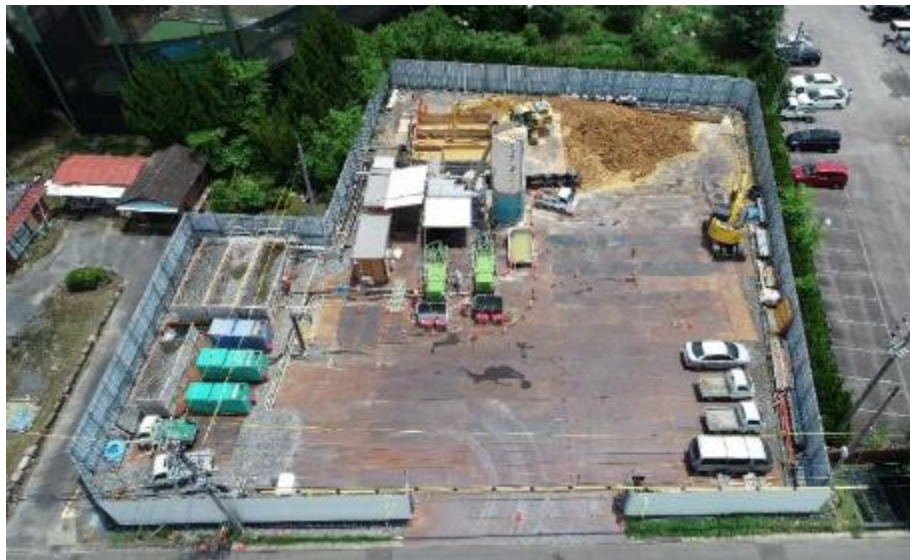
現場設置型プラント
