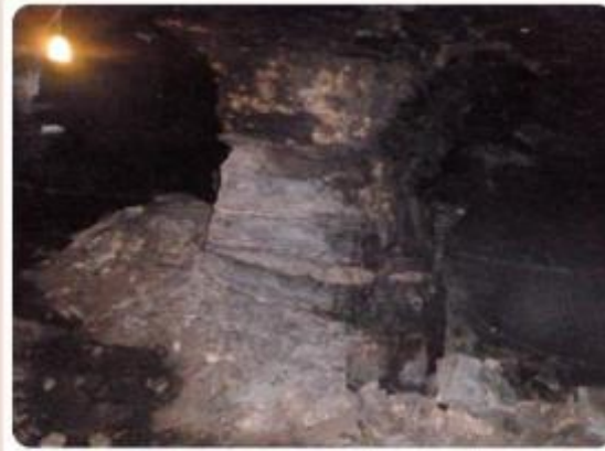
風化・劣化が進む残柱
