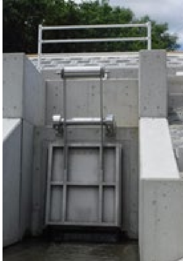
オートゲート (河川用)
