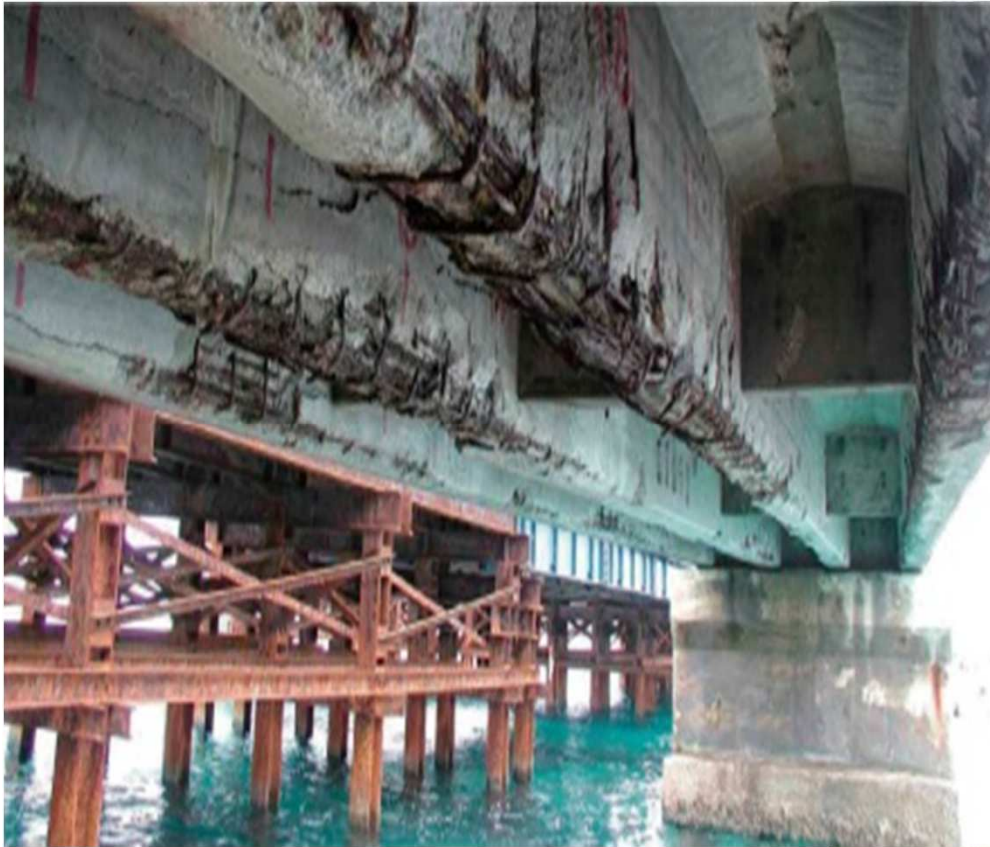
塩害による劣化
