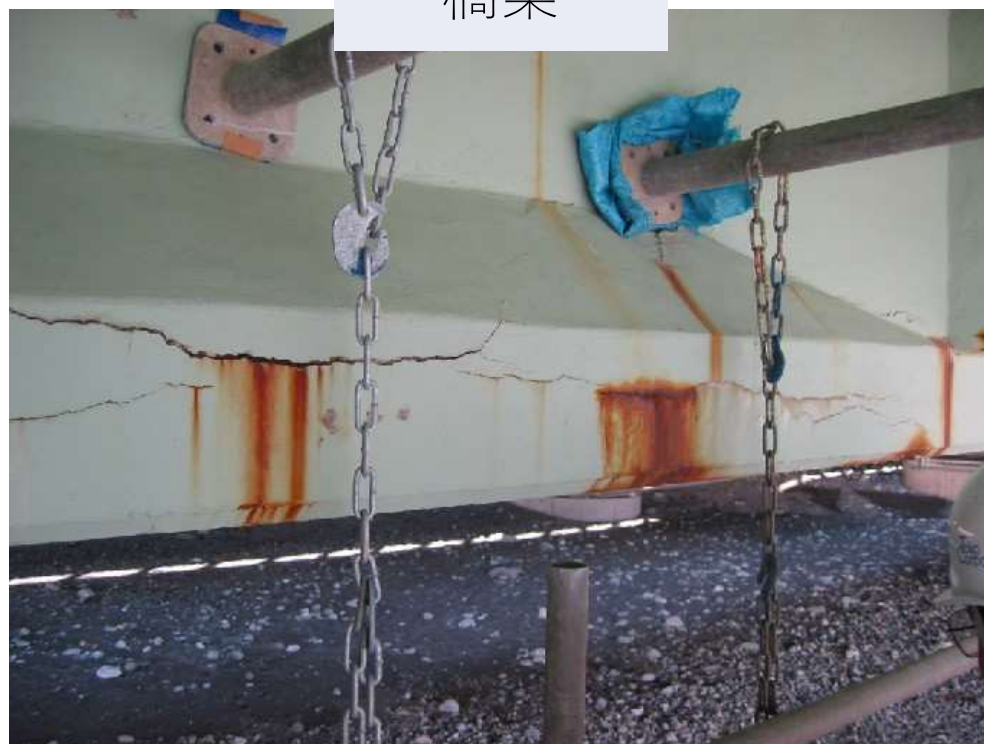
補修後の再劣化
