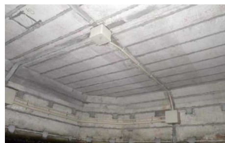
電気防食事例
