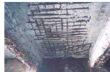
栈橋の損傷事例
