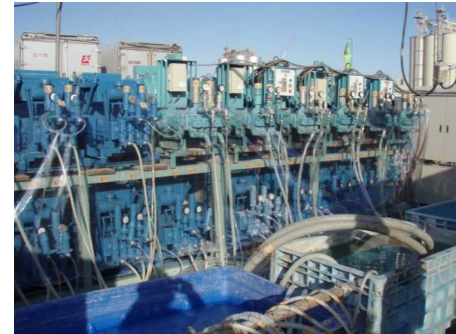
薬液注入ポンプ
