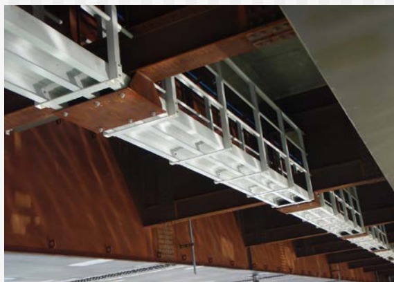
FRP検査路 瀬戸中央橋上部工検査路(長崎県)
