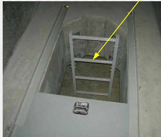
FRP点検孔蓋・梯子
