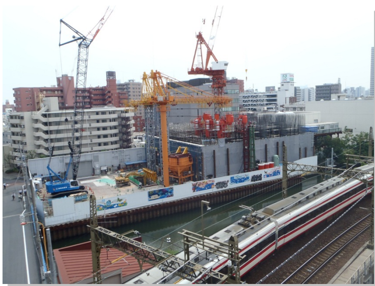
東京都業平橋ポンプ所
